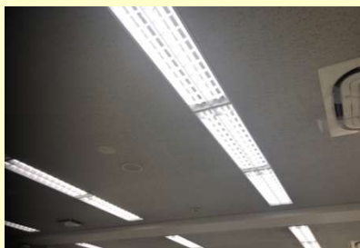
事務所内 LED 照明
